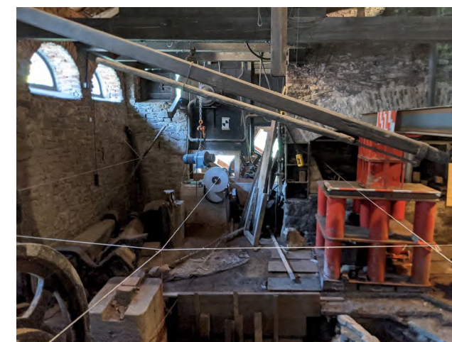
Hammergebäude, Hochwasser 2021 © Klaus Kaiser / Konsortium Deilbachtal
