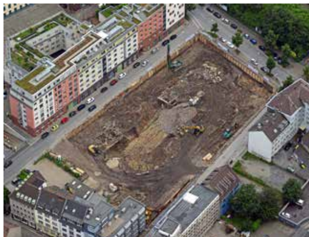
Das Luftbild vom 19.07.2016 zeigt bereits freigelegte Fundamente von Nordwesten (Foto: Baoquan Song)
