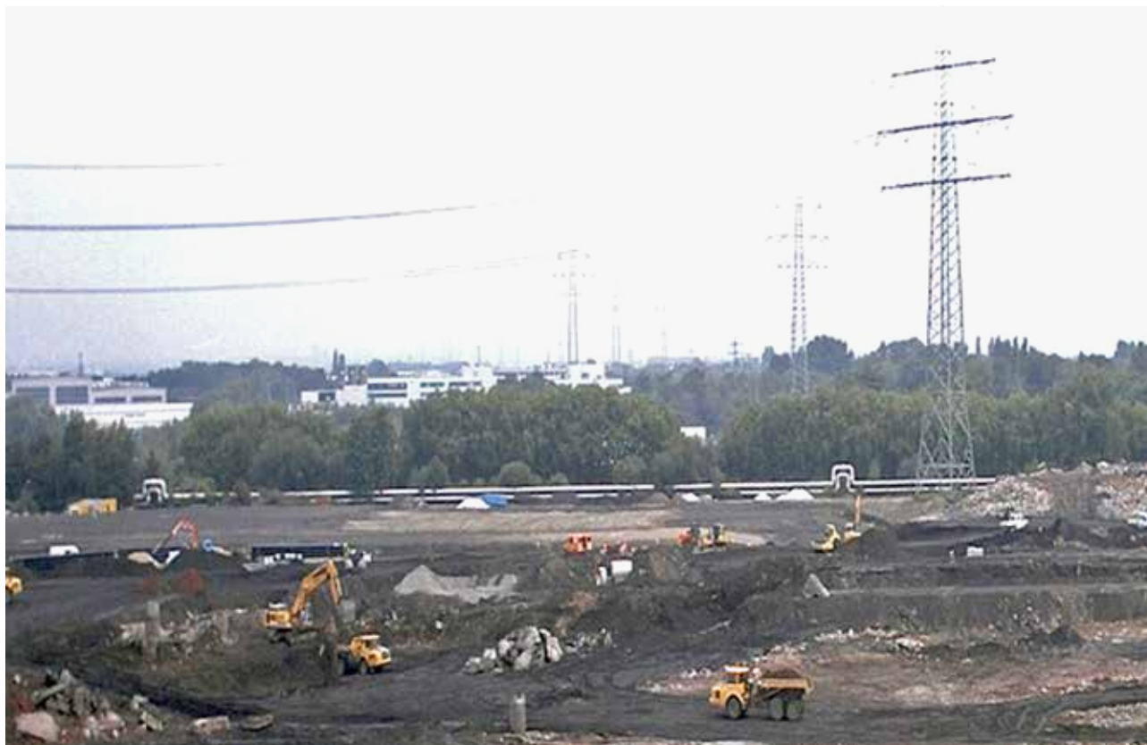
Das Bild ist bei der Baubegleitung zum ThyssenKrupp-Quartier im Jahr 2007 entstanden. Im Hintergrund ist eine Fernwärmeleitung zu sehen (Vergleich Bild rechts unten, Foto: Detlef Hopp)
